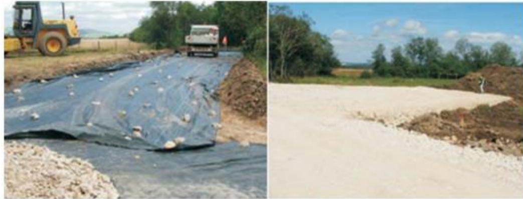
Figure 36 : Pose d'un géotextile (à gauche), état final d'une plateforme (à droite) (Source : EDF power solutions)
